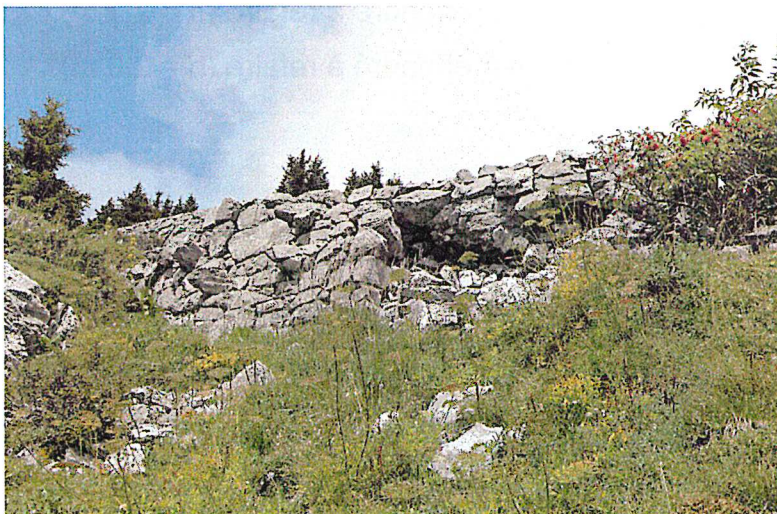
Figure 4 : Secteur Riondaz, terrasse 18 effondrée sur h = 2.9 m et l = 7.5 m.
