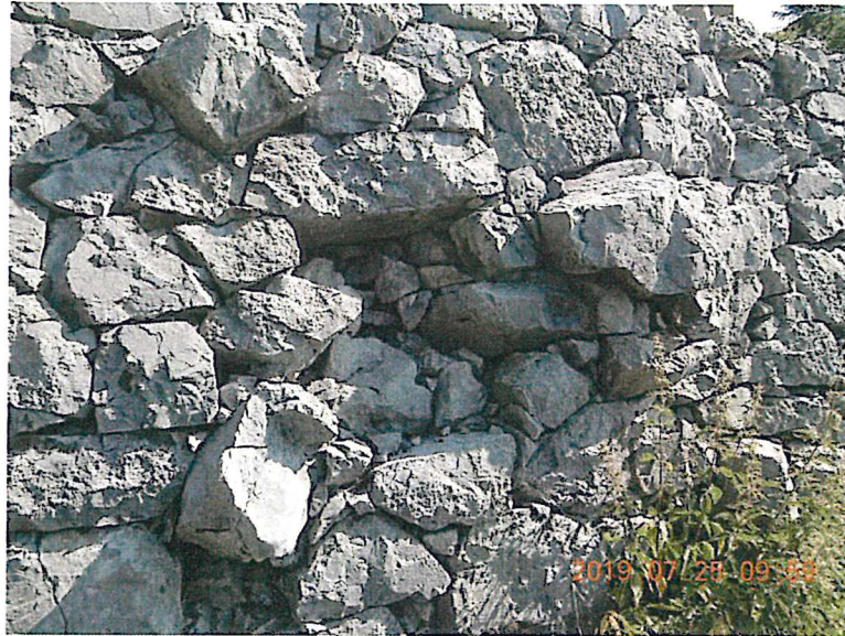
Figure 5 : Secteur Riondaz, blocs manquants dans le mur de la terrasse 14 (centre).
