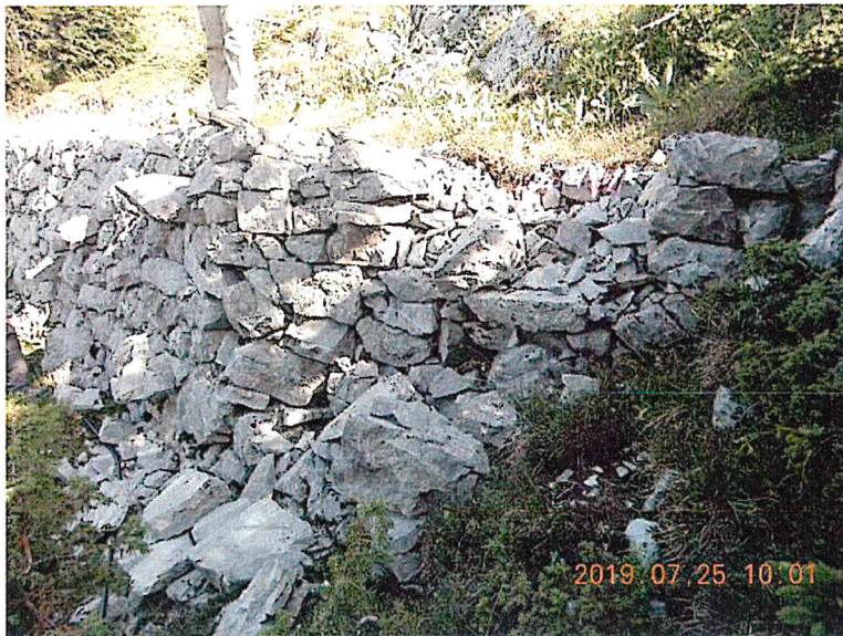
Figure 3 : Secteur Riondaz, bord de la terrasse 14 côté droit à refaire sur 3 m 2 .
