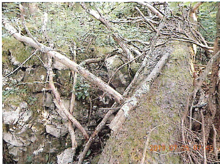
Figure 1 : Arbres à débiter et démontage de la partie de mur endommagée.
