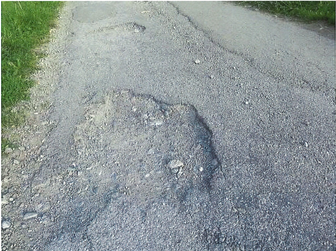
Photo 10 : Chemin de la Crête du Fer (chemin n°7), nid de poule, revêtement de faible épaisseur.
