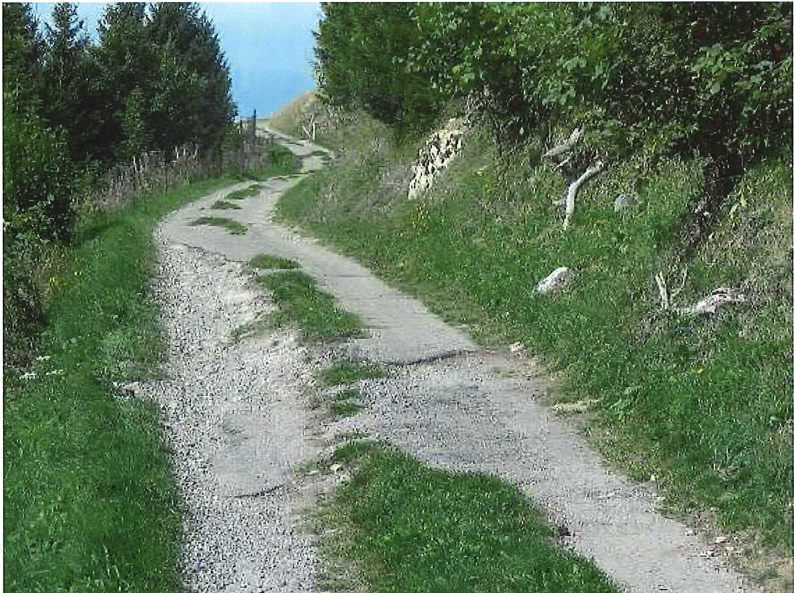
Photo 3 : Chemin de Prafandaz supérieur (chemin n°9) avec de forts tassements et un revêtement dégradé.
