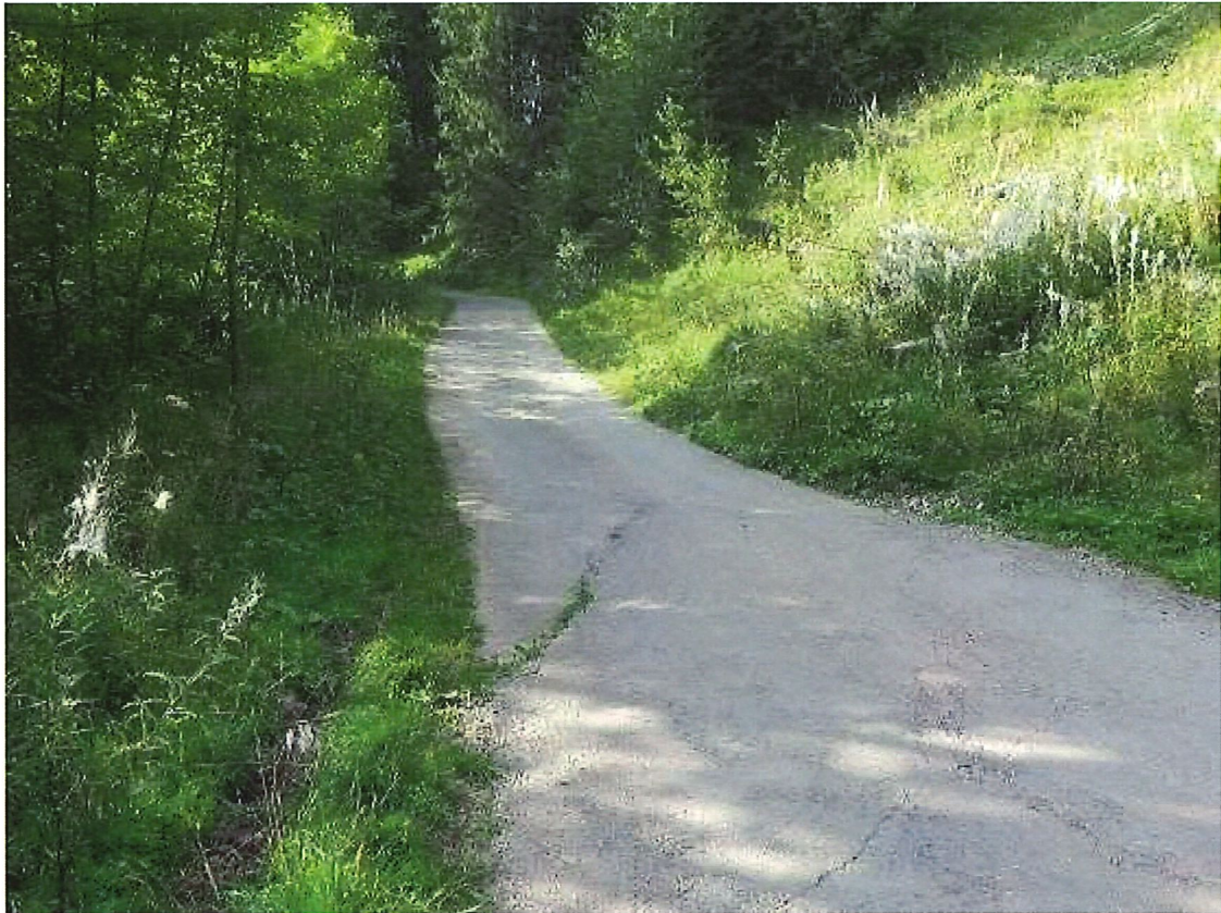
Photo 6 : Chemin n°5, tassement à stabiliser sur 12 m.
